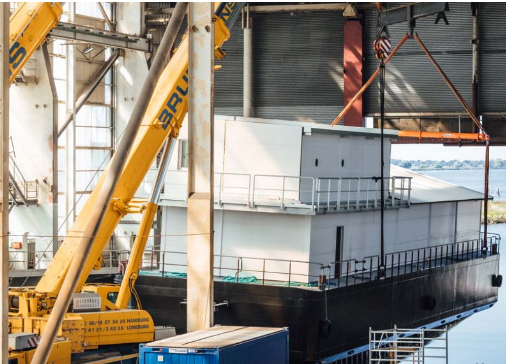
Stapelhub der neuen Bunkerstation bei der Hitzler Werft in Lauenburg
